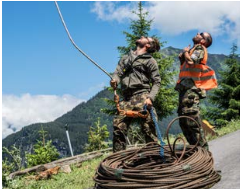
I cavi metallici vengono sezionati in diversi segmenti ed in seguito arrotolati per poi essere sgomberati.
