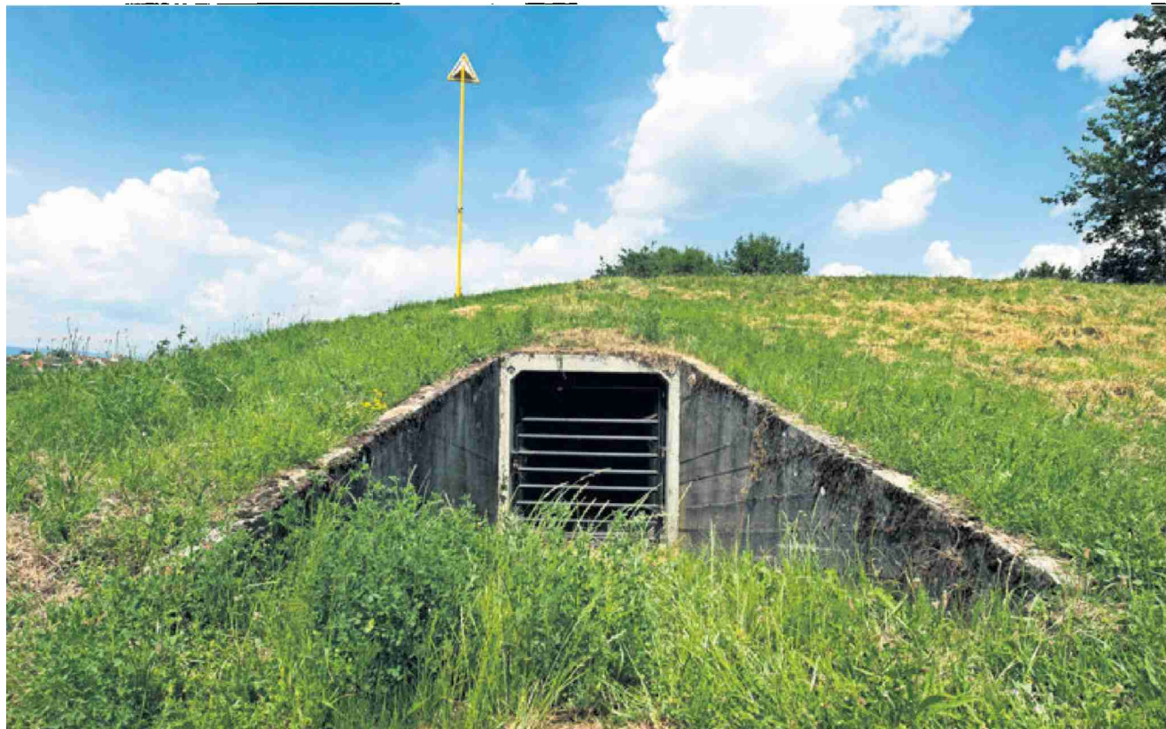
Des barres horizontales ont remplacé les portes des abris pour laisser un passage aux chauves-souris. JEAN-PAUL GUINNARD
