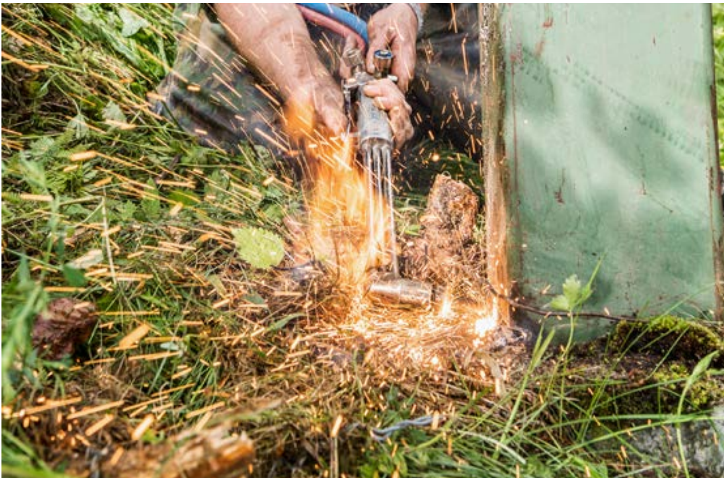
Achtung Gefahr! Sicherheit wird grossgeschrieben, vor allem wenn die Stahlmasten entfernt werden.
