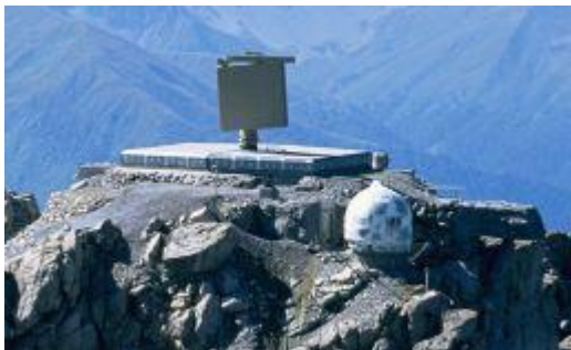
Figura 17: Antenna radar del sistema FLO-RIDA.
