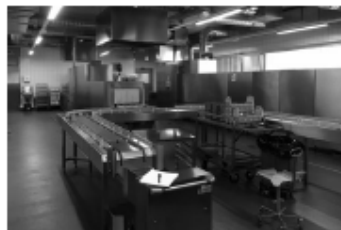
Abwaschstrasse für Ess- und Küchengerätschaft
