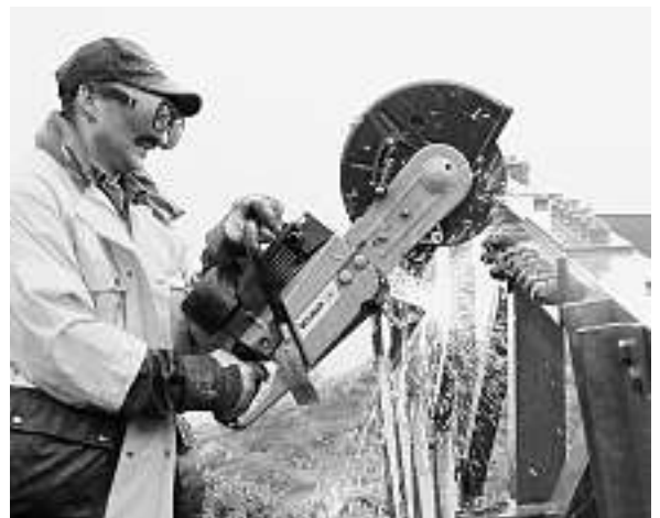
Arthur Venzin, Seilbahnspezialist der Luftwaffe, geht mit der benzinbetriebenen Trennscheibe zu Werk: Ziel sind lufttransportfähige Teile.
